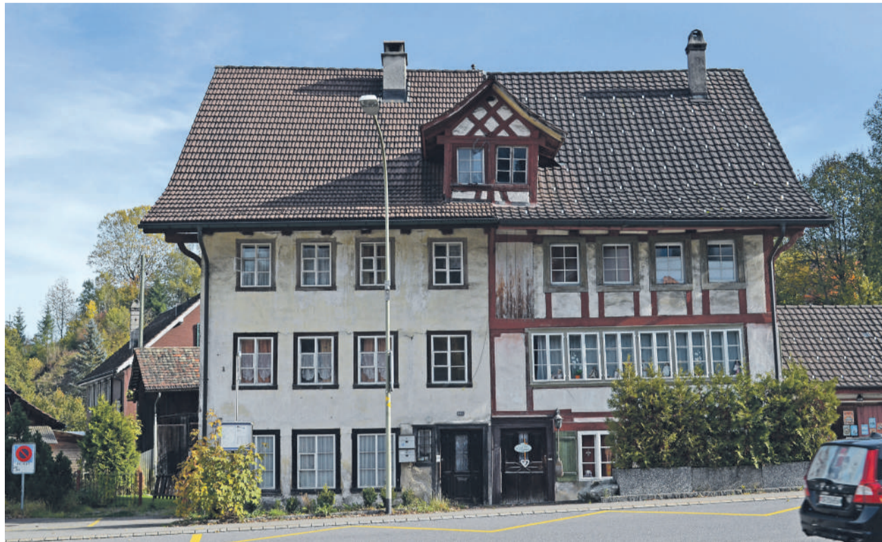
Eines der ältesten Häuser: das Haus zur Farb, ein prächtiger Riegelbau, der leider dringend renovationsbedürftig ist
